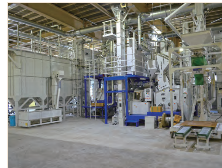
粳摺調整設備 (4.5t/h x 2 基)
